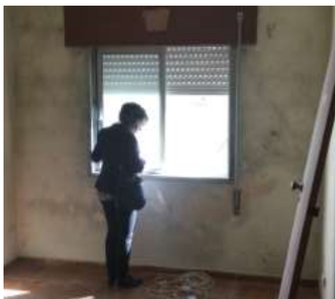
MANCHAS EM PAREDES
