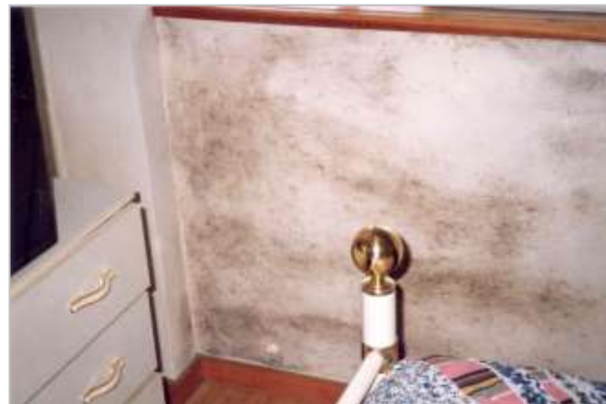
INFILTRAÇÃO DE ÁGUA PELO CONTORNO DOS VÃOS
