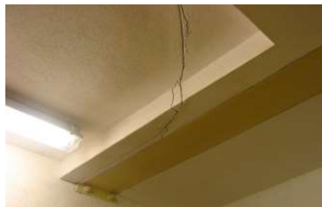
FISSURAS (EM TETOS E PAREDES)
